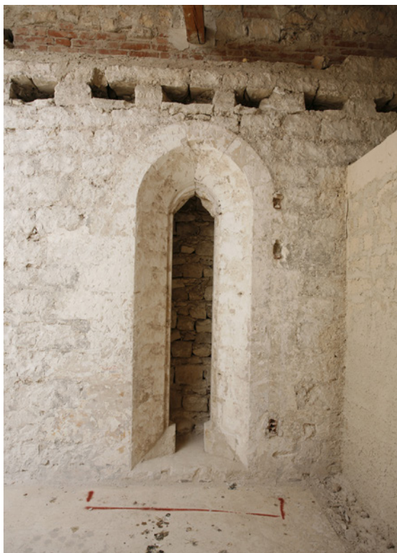
Fig. 12 - Carmine: monofore della chiesa preterremoto.
