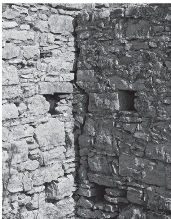
Fig. 12 - Dormitorio, vano 02; dettaglio della struttura muraria e dello scarso collegamento tra la parete longitudinale (a sinistra) e i muri divisorii (a destra) [Image credits: C. Winterstein, 2016].
